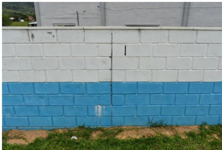
Figura 74 Detalhe do muro com junta de dilatação sem o tratamento de vedação.
