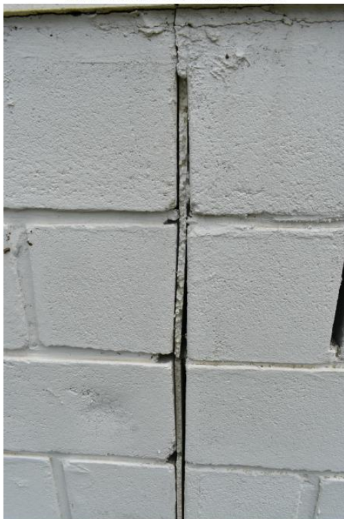
Figura 75 Ausência do serviço de vedação de juntas.
